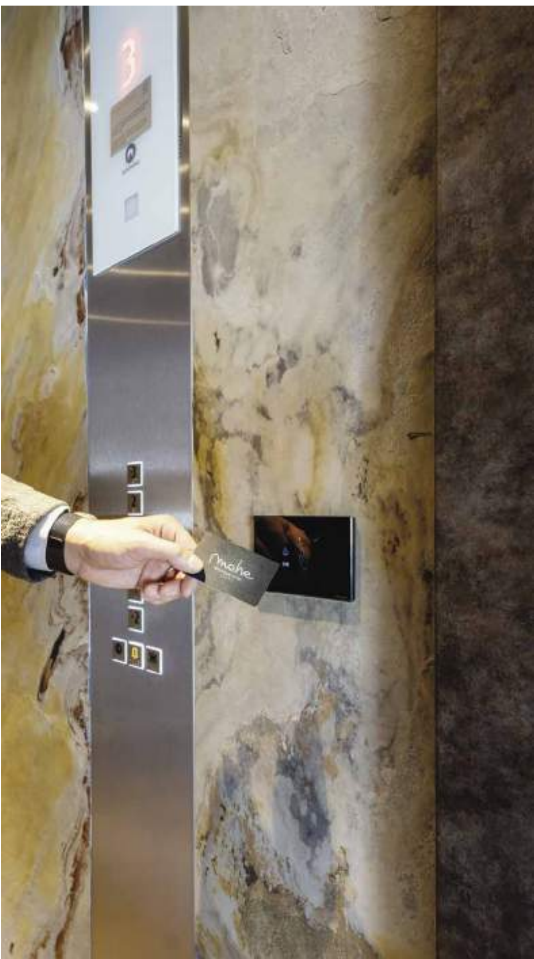
Dettaglio dell'ascensore: l'accesso a specifiche aree della struttura è controllato anche attraverso un lettore badge collocato in ascensore, garantendo massima sicurezza per gli ospiti e un controllo affidabile per la proprietà (Microdevice) .
