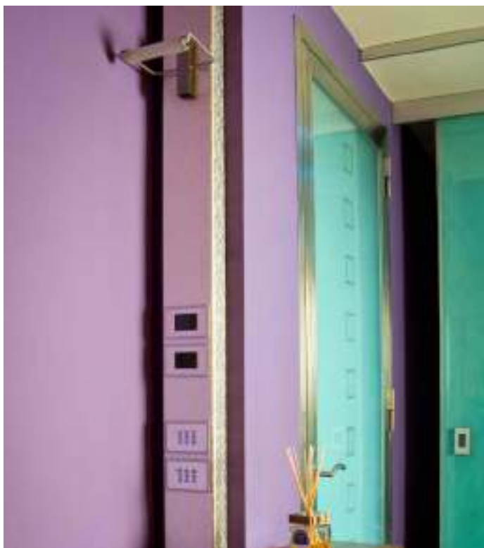
Colunbus argento spazzolato personalizzata con pannelli gestione luci, citofono e inserimento lampada di design. Qui in una villa in provincia di Brescia.
